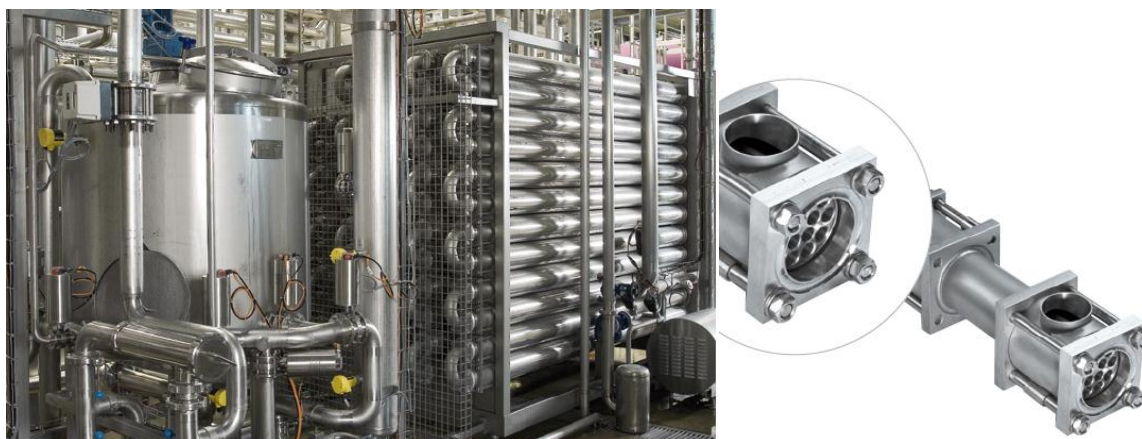
Fig. 3.4. Instalație pentru tratamentul UHT cu schimbătoare de căldură tubulare
